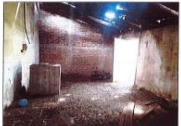
HABITACIONES EN MAL ESTADO. NO VALUADA
