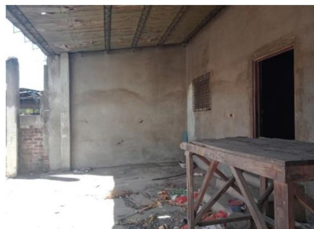
CONSTRUCCION MAL ESTADO NO VALUADA
