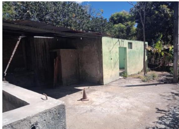
CONSTRUCCION MAL ESTADO NO VALUADA
