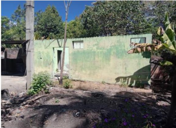
CONSTRUCCION MAL ESTADO NO VALUADA
