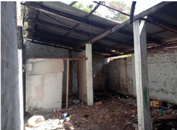
CONSTRUCCION MAL ESTADO NO VALUADA
